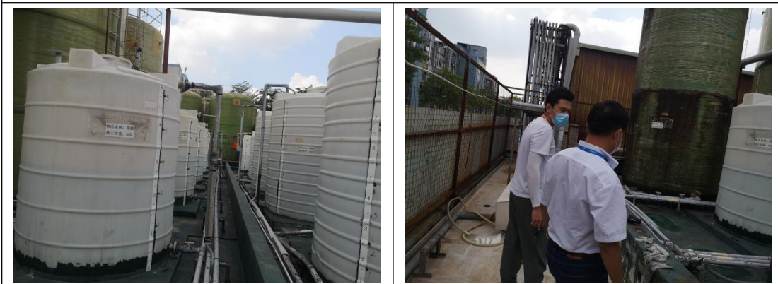
废水站药水平台
