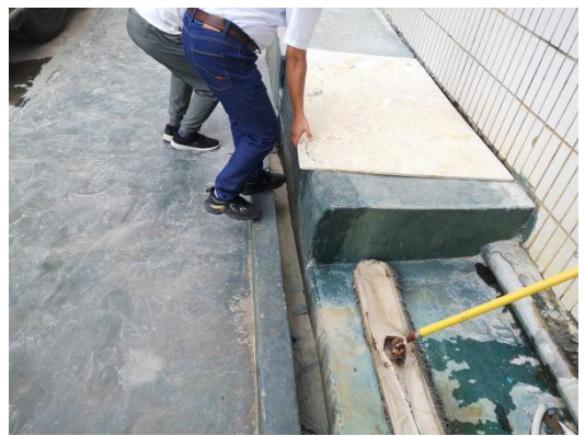
污泥压滤废水回流管道
