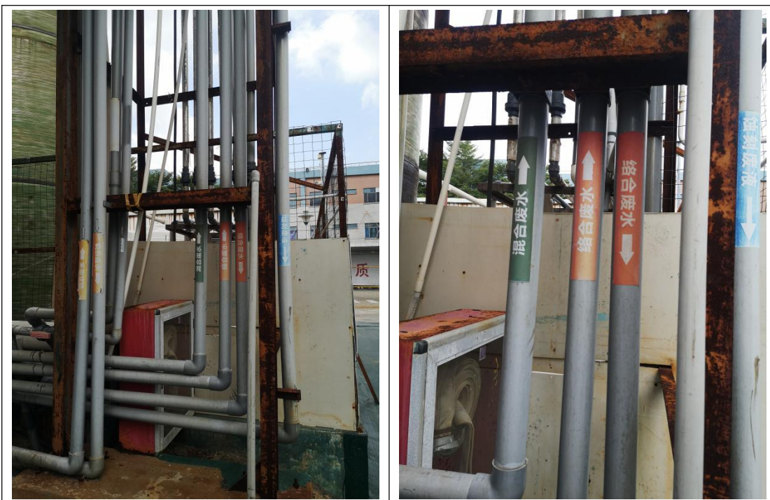
废水传送管道
